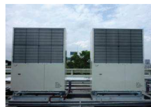
高効率型空調設備
