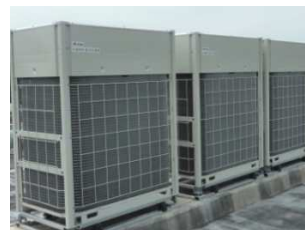
高効率型空調設備
