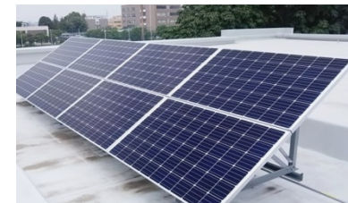
太陽光発電設備
