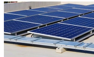
太陽光発電設備
