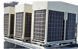
高効率型空調機
