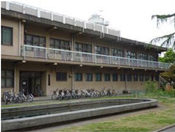
教育学部 C 棟 (外壁の劣化が著しい)
