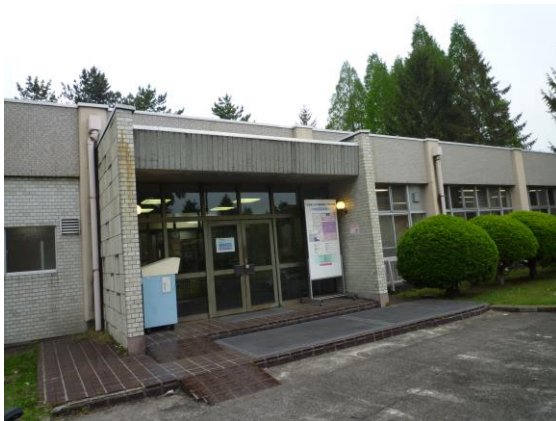
附属図書館分室 （外壁の劣化が著しい）
