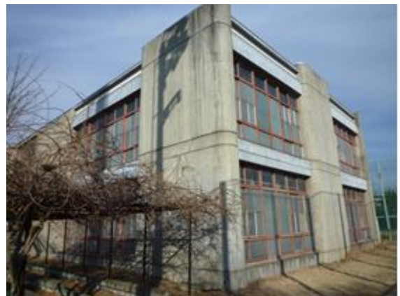
武道場 (外壁の劣化が著しい)
