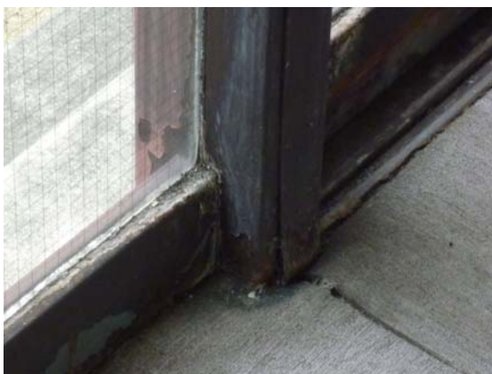
校舎 (スチールサッシの劣化が著しい)
