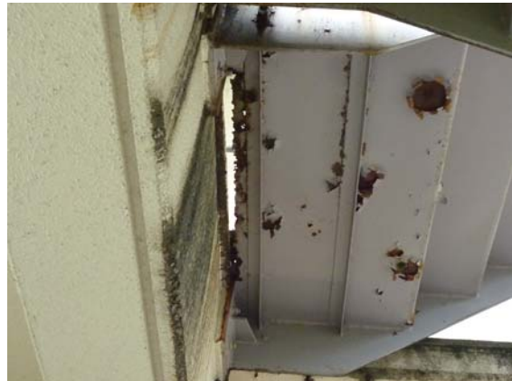
応用化学学科校舎（1号館） (屋外階段の腐食)
