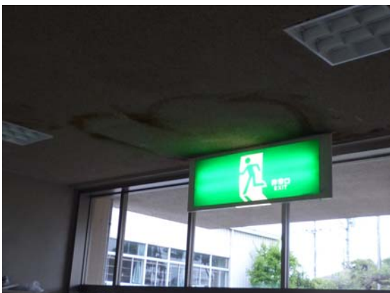
校舎 (漏水による劣化)
