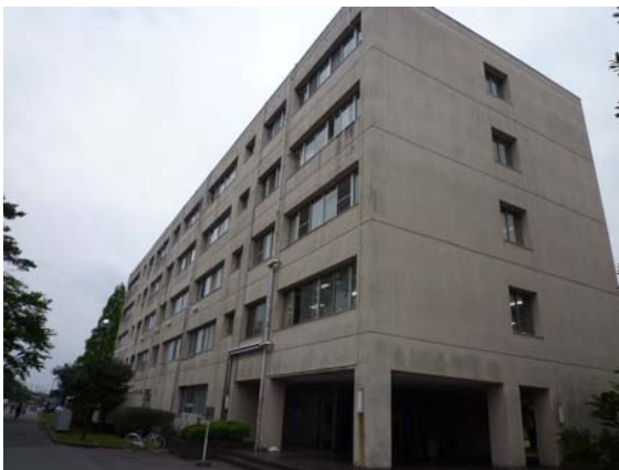
建築学科（8号館） (外壁の劣化が著しい)
