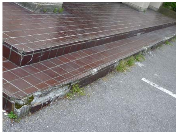
建築学科（8号館） (玄関ポーチの段鼻が破損)
