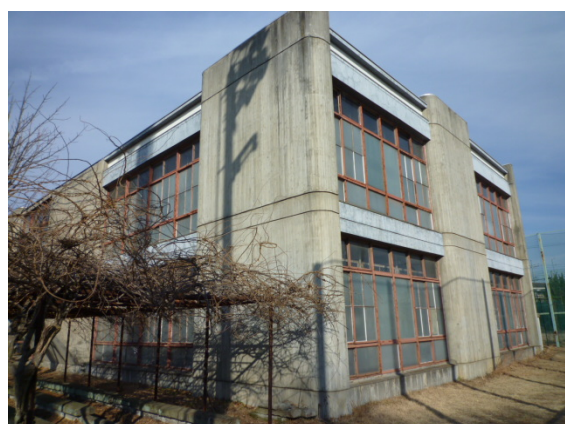
武道場 (外壁の劣化が著しい)
