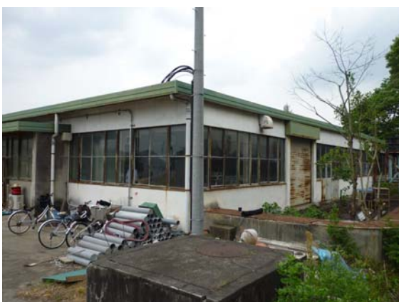
工作実験室 (スチールサッシの劣化が著しい)
