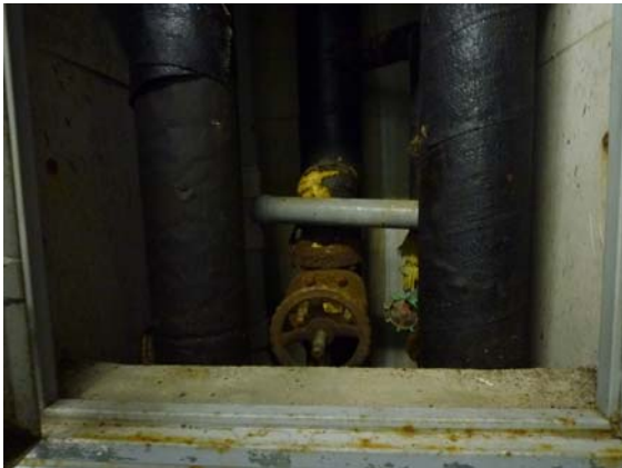
応用化学学科校舎（1号館） (配管バルブが腐食)
