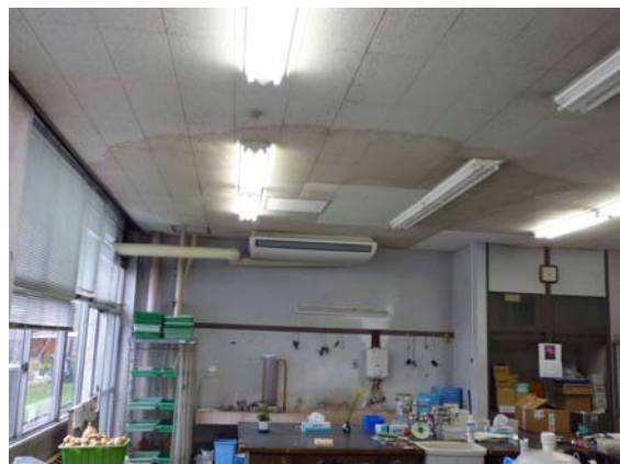
雑草科学研究センター (漏水と経年劣化による老朽化)
