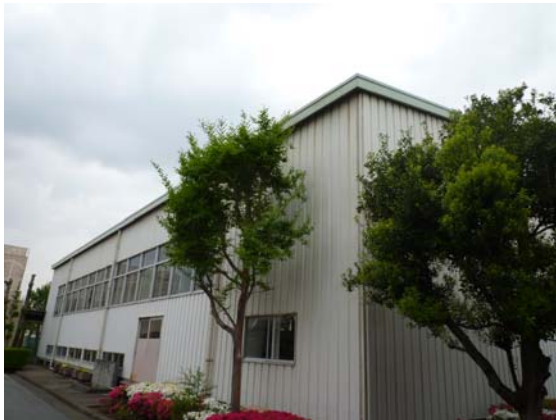
体育館 (外壁の劣化が著しい)
