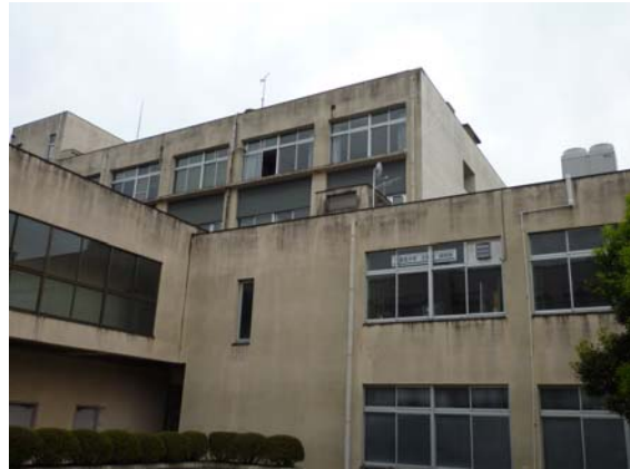
応用化学学科校舎（1号館） (外壁の劣化が著しい)
