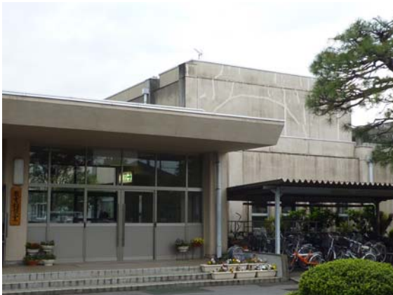
校舎玄関周り (外壁の劣化が著しい)
