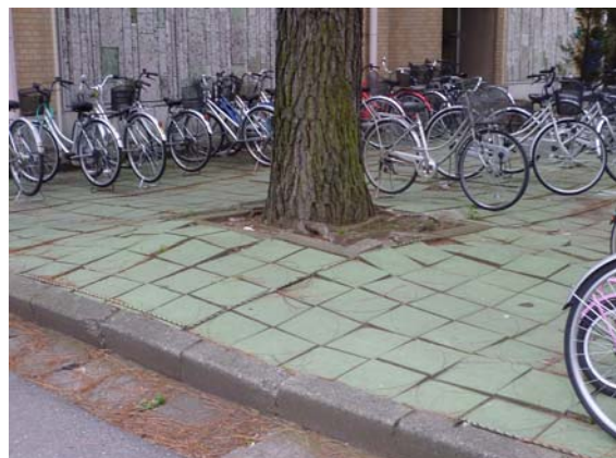
電気電子工学科校舎（4号館）の東側 (根の盛り上がり)
