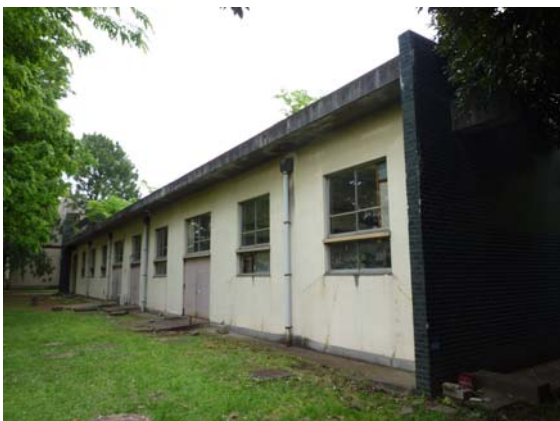
機械・電気実験室（6号館） (外壁の劣化が著しい)
