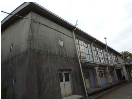
附属小学校体育館 (外壁の劣化が著しい)
