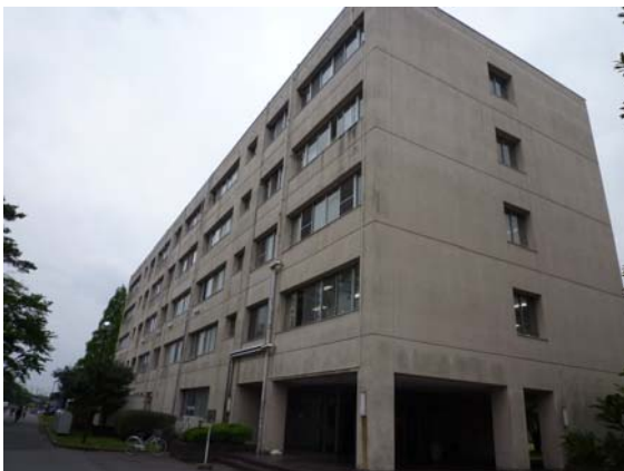
建築学科（8号館） (外壁の劣化が著しい)
