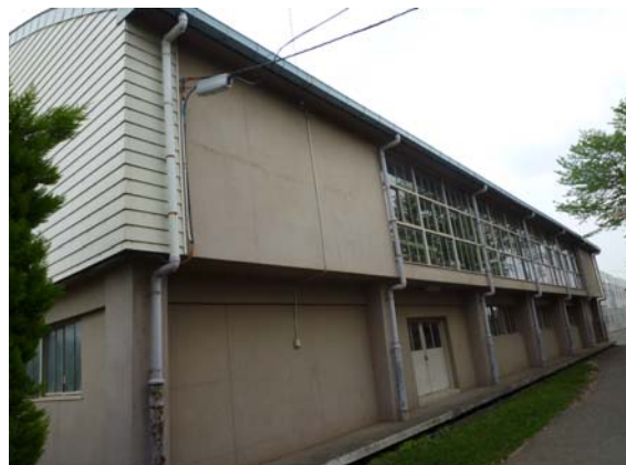
附属中学校体育館 (外壁の劣化が著しい)
