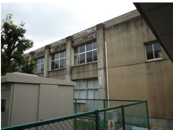
高等部校舎 (外壁の劣化が著しい)
