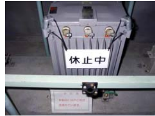
PCBの含有が確認された変圧器
