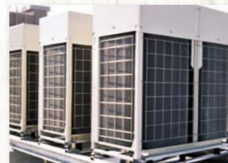
高効率空調設備
