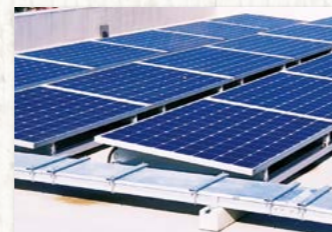
太陽光発電設備
